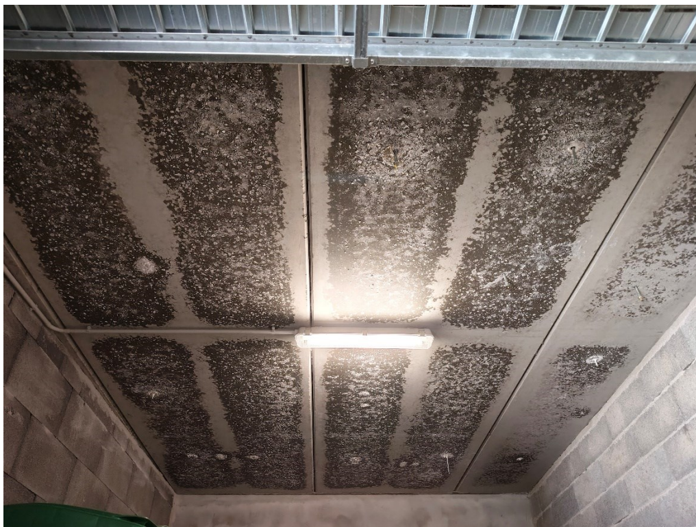
Infiltrazioni box - solaio di copertura
