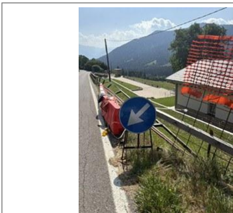
Foto A.3 – Stato al 5 agosto 2026: barriera metallica divelta e barriere plastiche mobili sul ciglio (nota prot. n. 7996, foto 1).
