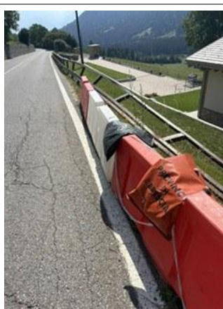
Foto A.4 – Stato al 5 agosto 2026: presidio provvisorio e componenti del guard-rail rovesciati lungo il versante (nota prot. n. 7996, foto 3).
