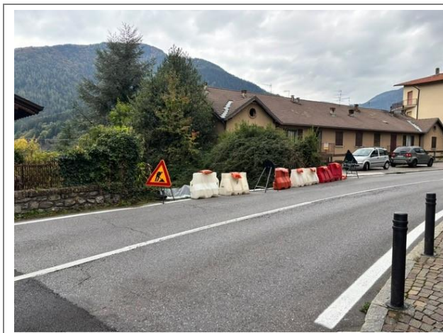
Foto B.1 – Vista d'insieme del tratto: barriere mobili in plastica di tipo e colore diversi lungo il margine della carreggiata, cartello di lavori in corso e telo a copertura dell'area del crollo; sul lato opposto, marciapiede delimitato da dissuasori.
