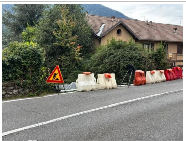
Foto B.2 – Dettaglio: telo a copertura dell'area del crollo, adiacente al tratto superstite del muretto in pietra; barriere mobili in plastica sul margine della carreggiata.
