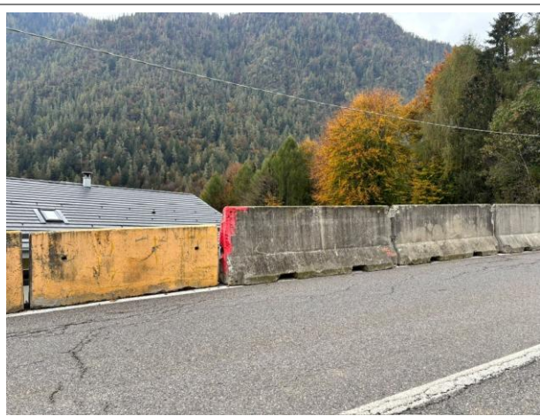
Foto A.2 – Stato attuale: accostamento di elementi «New Jersey» di diversa tipologia, con discontinuità tra gli elementi; sullo sfondo, la copertura del fabbricato sottostante.
