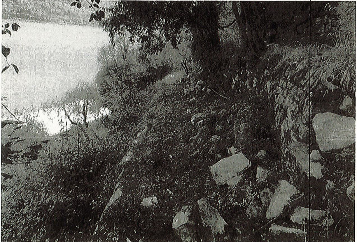
Foto n.2: Sentiero comunale – situazione instabile
