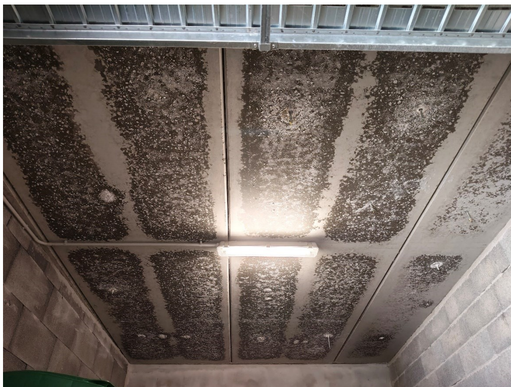
Infiltrazioni box - solaio di copertura
