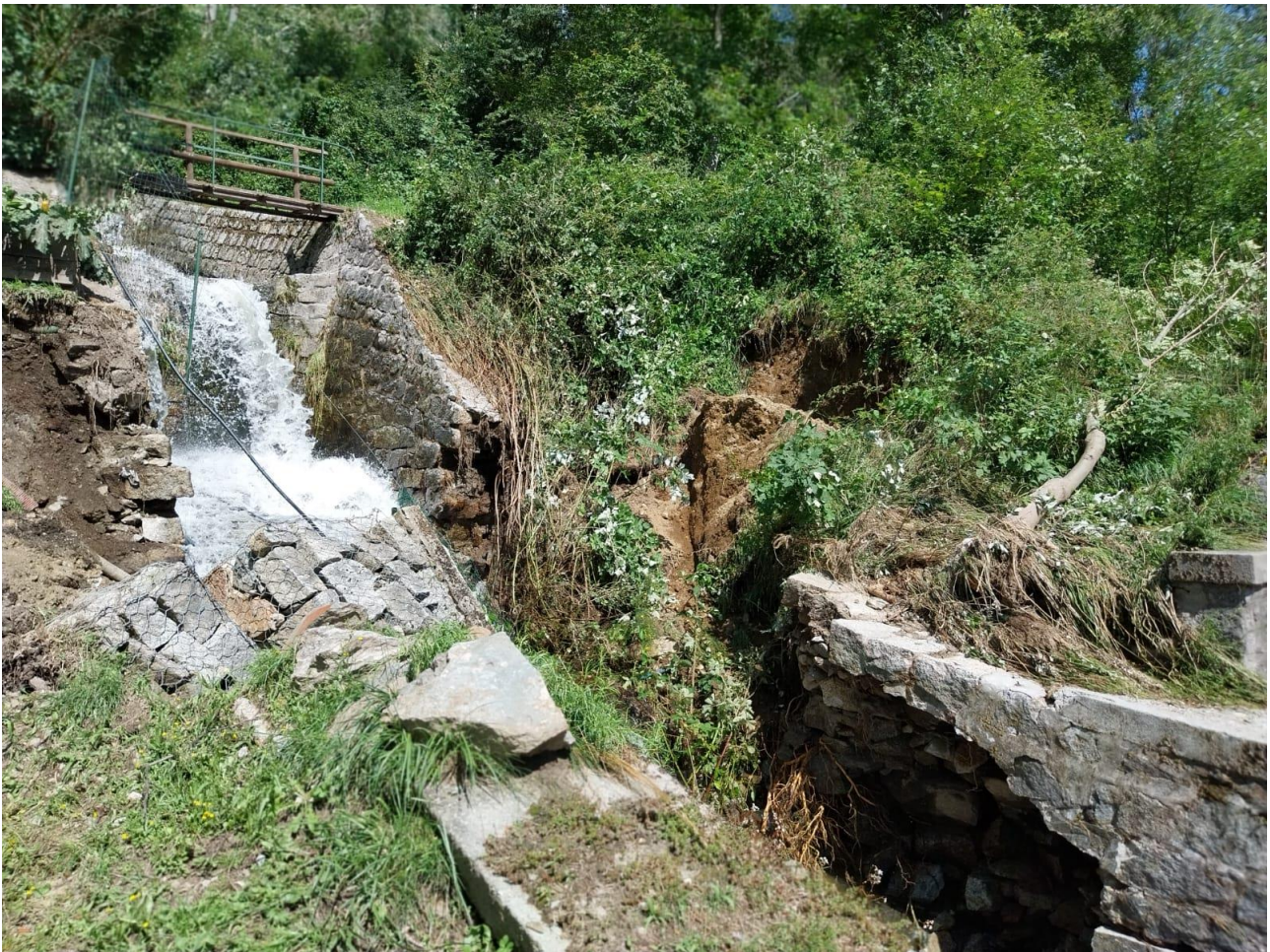
Crollo delle protezioni spondali in prossimità del mappale n. 55 (in sponda sinistra idraulica)
