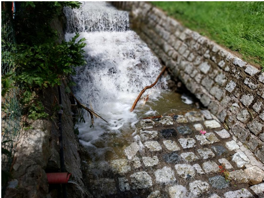
Danni all'alveo e al piede dell'argine in sponda sinistra in prossimità del mappale 33
