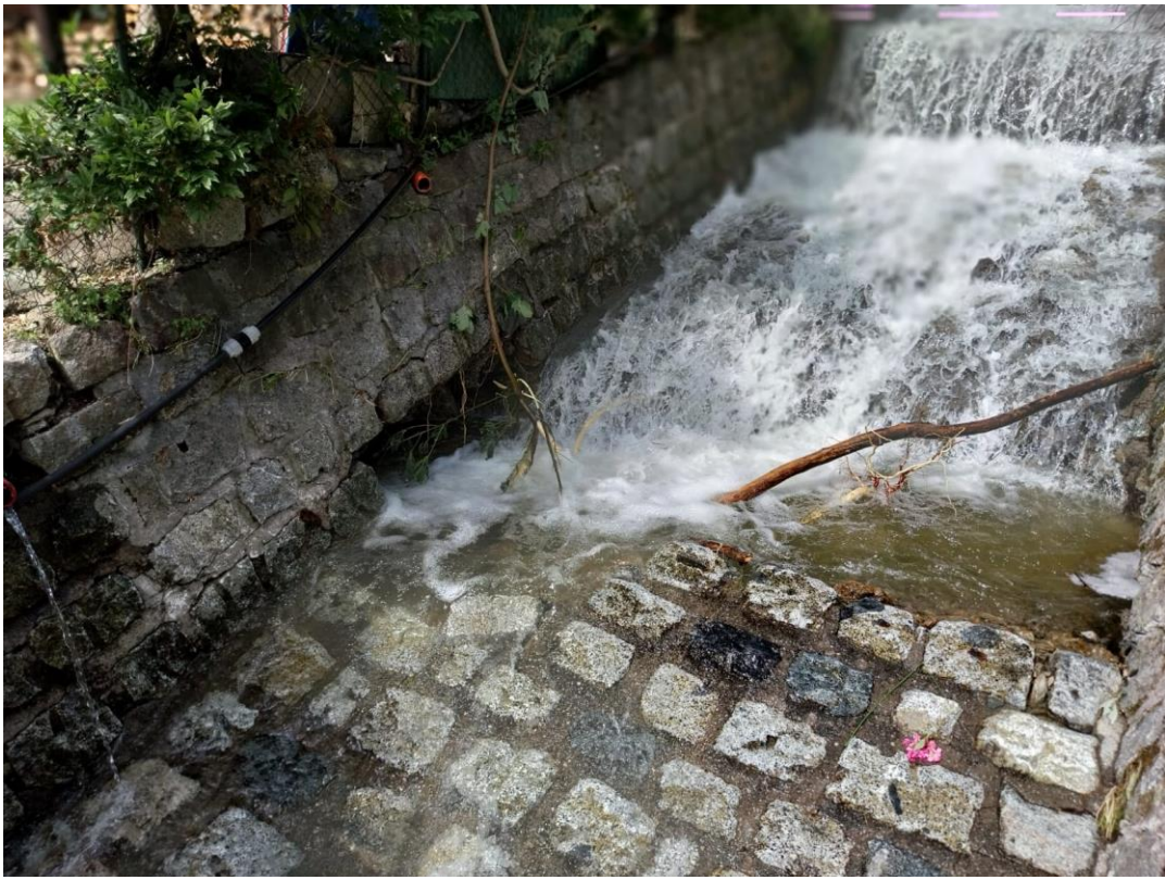
Danni all'alveo e al piede dell'argine in sponda destra in prossimità del mappale 11
