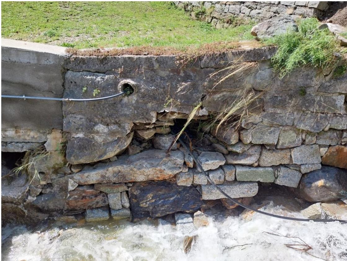
Crollo delle protezioni spondali in prossimità del mappale n. 451 (in sponda destra idraulica)
