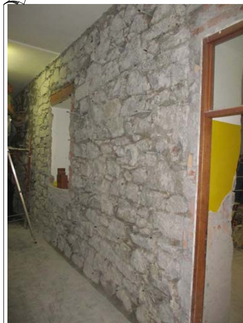
Parete pronta alla ricezione della rete di rinforzo. by Arch. Sergio Ghirardelli (DL)
