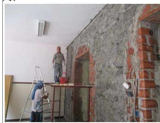
Posa rete di rinforzo del muro interno alla sala pranzo. by Arch. Sergio Ghirardelli (DL)
