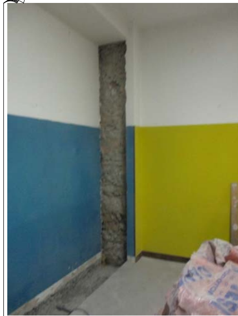
Demolizione lesena d'angolo per ammassamento parete M1. by Arch. Sergio Ghirardelli (DL)
