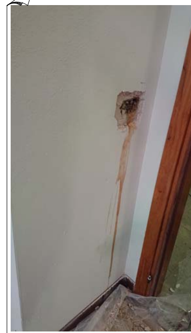
Demolizione localizzata nel punto indicato dalla termocamera by Sergio Ghirardelli (DO)
