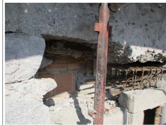
demolizione per formazione appoggio trave T2.I new by Arch. Sergio Ghirardelli (DL)
