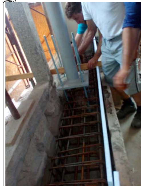
trave F1 lato Est - piano terra - gabbia di armatura da correggere by Arch. Sergio Ghirardelli (DL)
