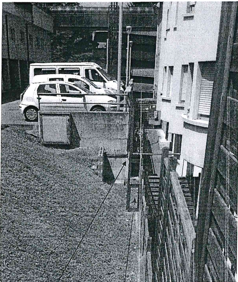
Tubazioni ed alimentazione basamento
