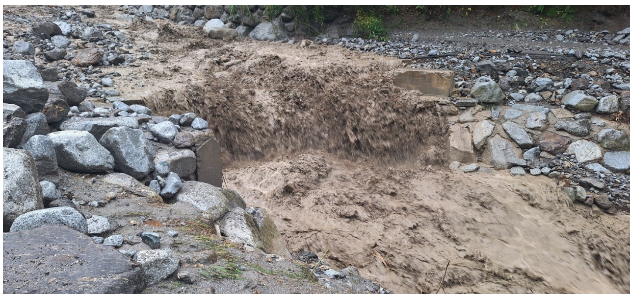
Danni al guado di Via Valeriana e alle difese idrauliche trasversali e longitudinali
