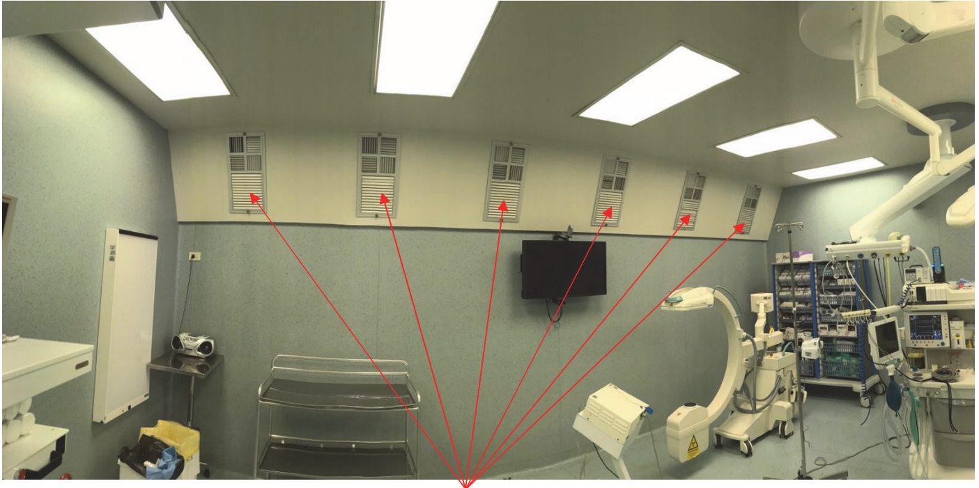
Vista canali di mandata aria sala operatoria chirurgia
