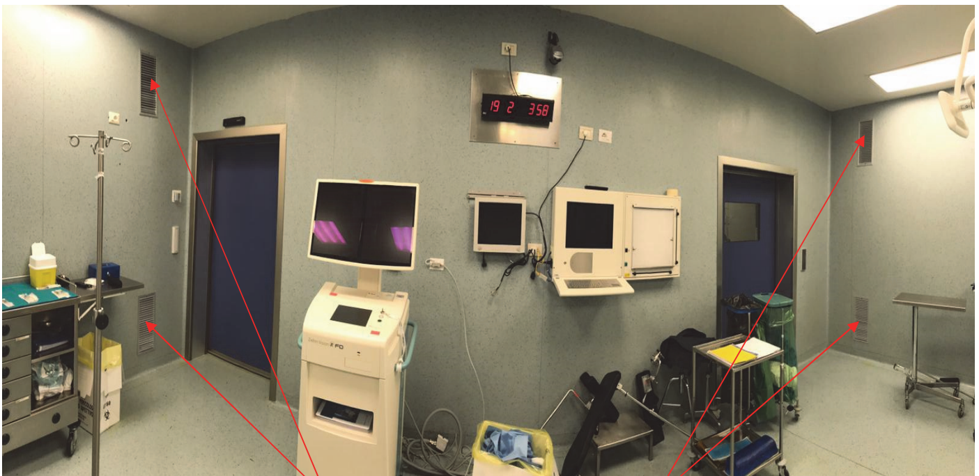
Vista canali di ripresa aria sala operatoria chirurgia
