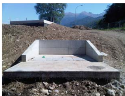
Stazione di sollevamento realizzata in Comune di Capo di Ponte
