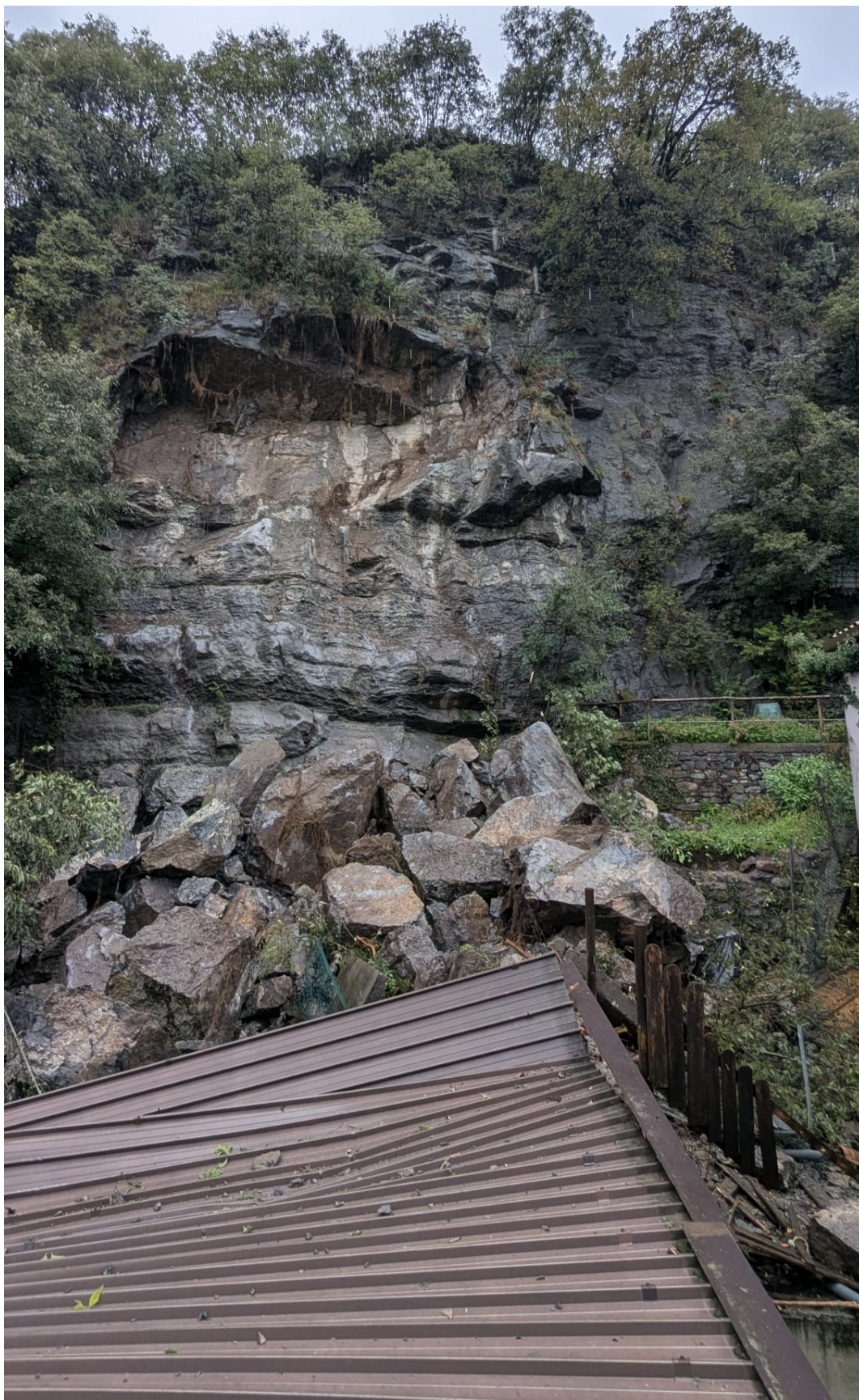
Zona della parete rocciosa da dove è avvenuto il distacco del materiale
