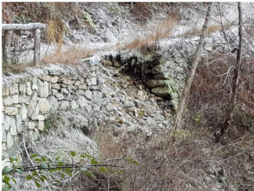
Vista del tratto di muro crollato
