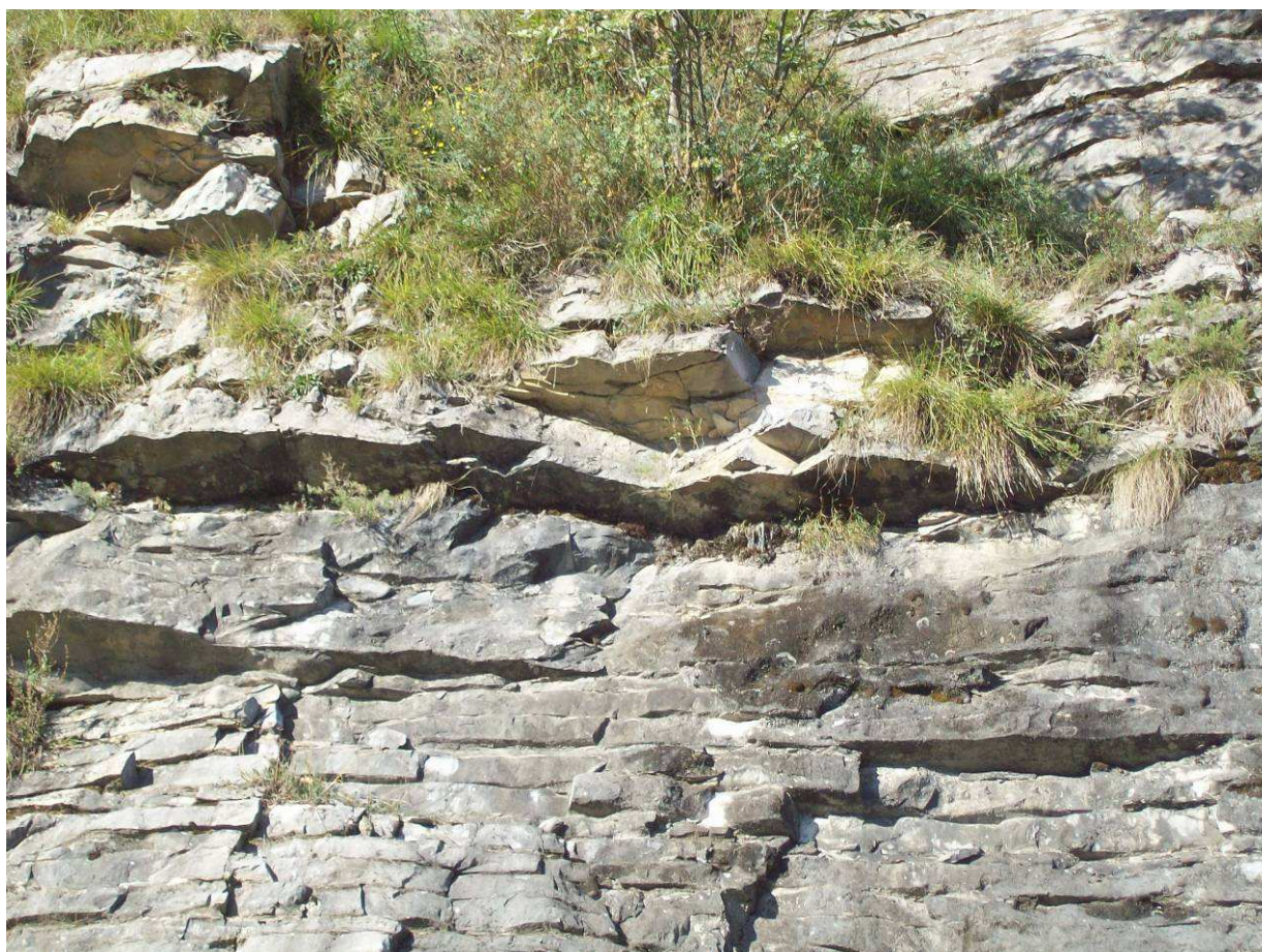
Foto 1: Vegetazione accresciuta all'interno delle fratture e di livelli marnosi dell'ammasso roccioso.
