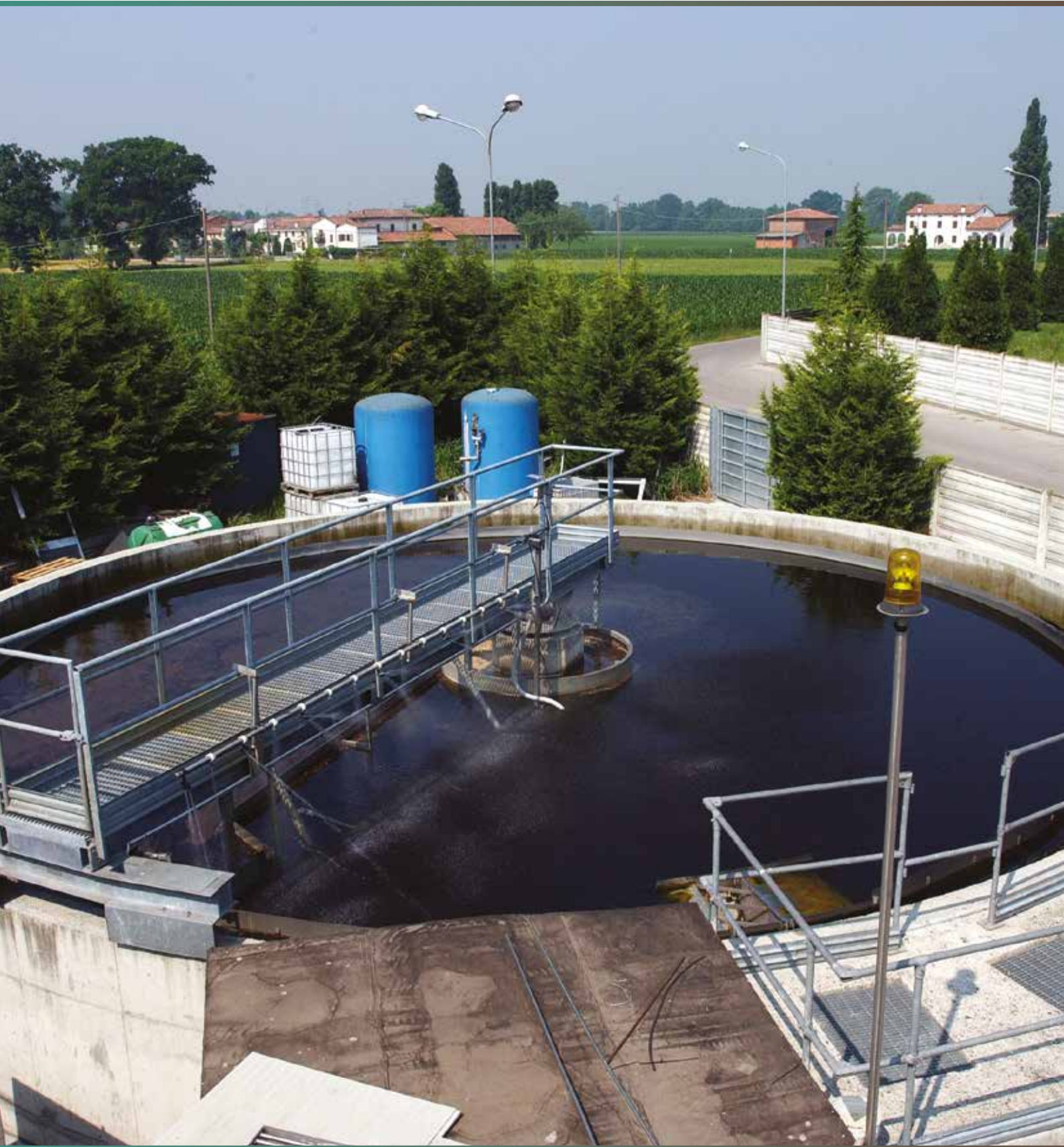
Foto 5.12 Sedimentatore con carroponte Fonte ISPRA Paola Orlandi
