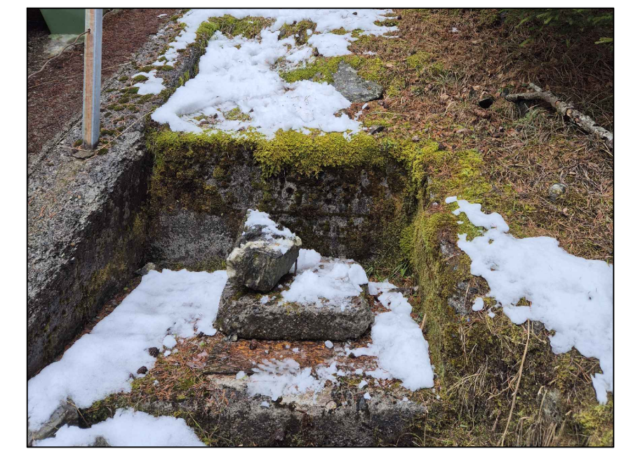
Foto del pozzetto dell'esistente acquedotto rurale posto in fregio alla condotta Enel
