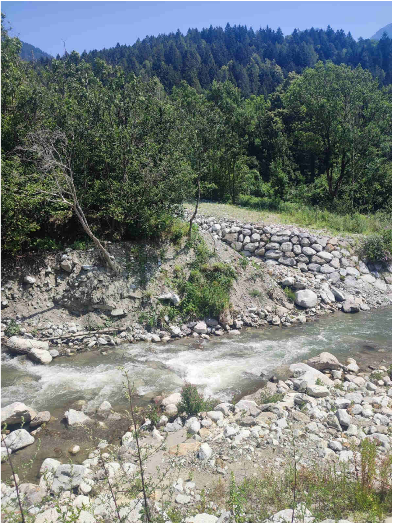
Sbocco del t. Val Finale e tratto di fiume Oglio verso monte, dove verrà formata la vasca di deposito.
