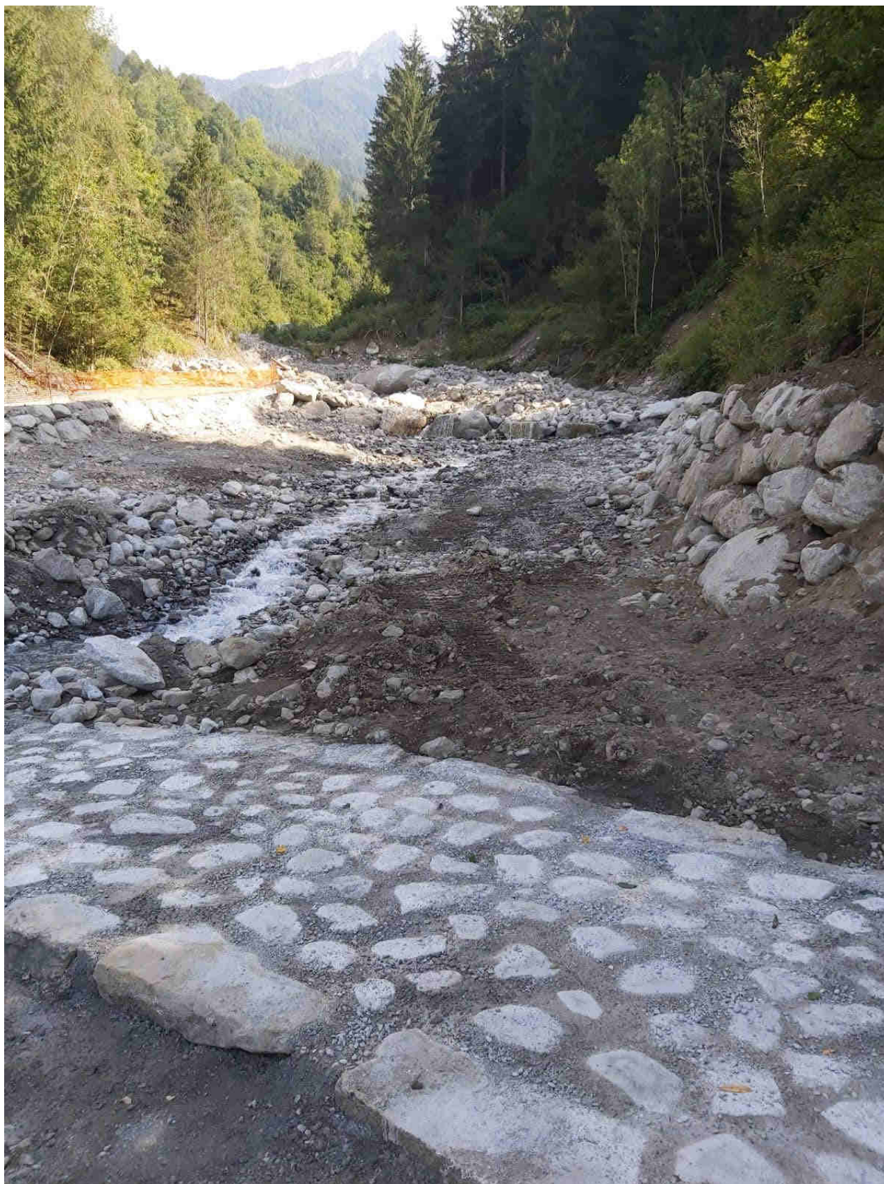
Vista dal guado. Si intravede la scarpata sinistra in degrado. In questo progetto è prevista la protezione di detta scarpata con scogliera intasata col calcestruzzo
