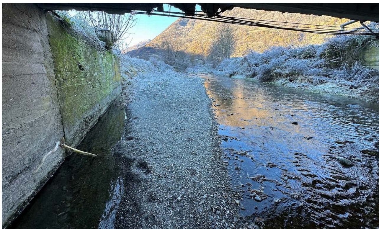
Figura 5 Spalla destra e muro d'argine destro verso monte (in c.a. non rivestito) da demolire e sostituire con una scogliera
