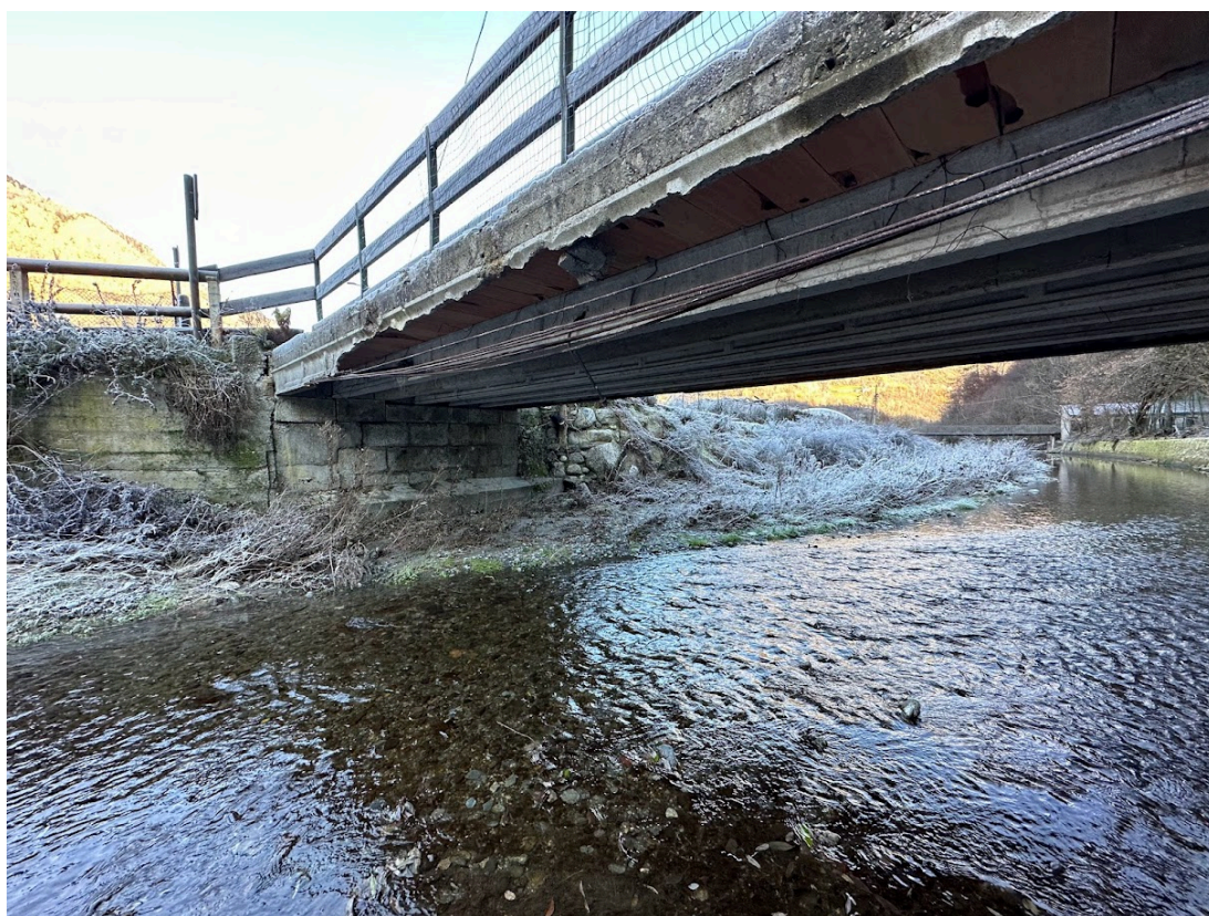
Figura 2 Impalcato esistente, spalla sinistra e tratto di muro d'argine (in c.a. non rivestito) da demolire
