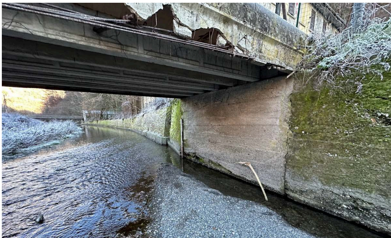
Figura 4 Spalla destra (in c.a. non rivestito) da demolire e sostituire con una scogliera
