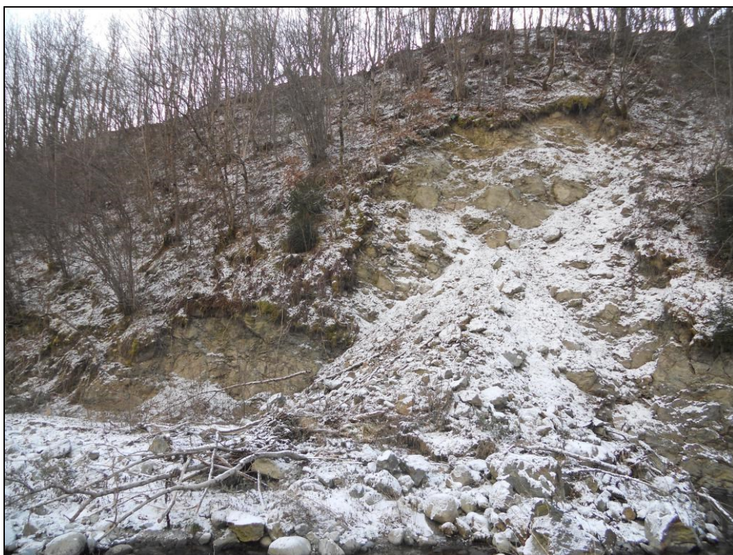
Vista frana in sponda destra
