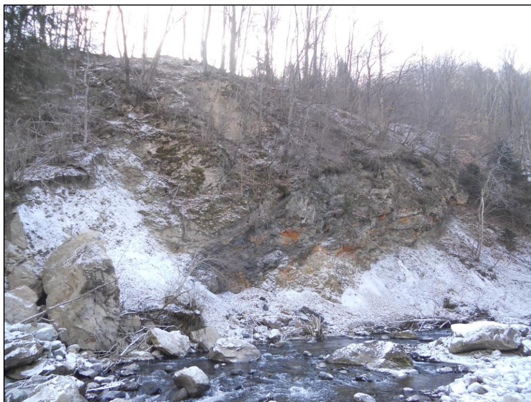
Vista frana in sponda destra
