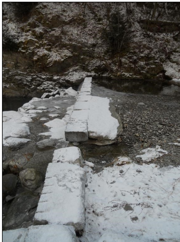
Copertina in pietrame mancante della soglia trasversale
