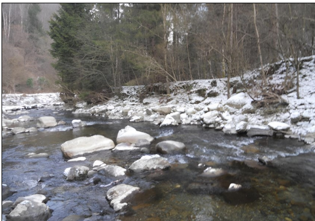
Scarpata erosa e scavernata in sponda destra
