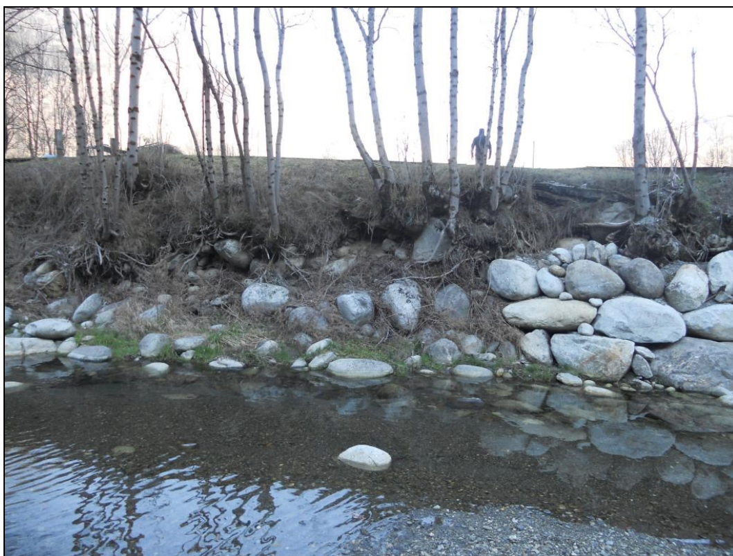
Scarpata erosa in sponda sinistra
