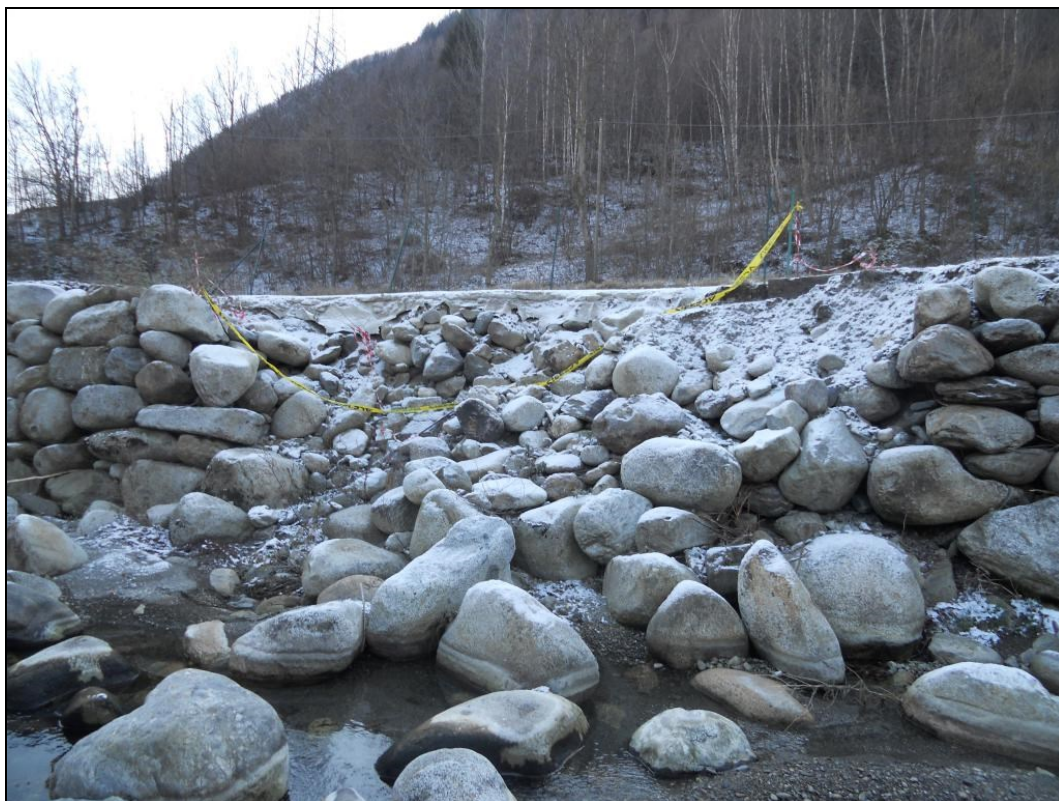
Scogliera crollata in sponda destra
