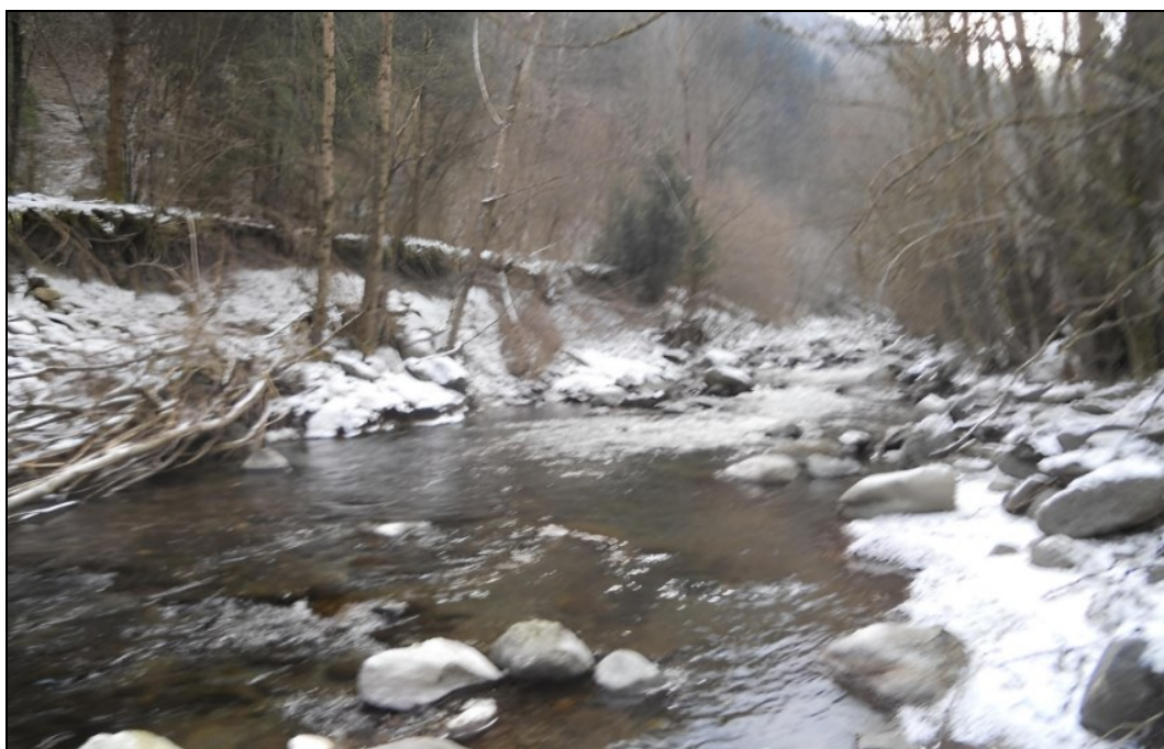
Scarpata erosa e scavernata in sponda destra
