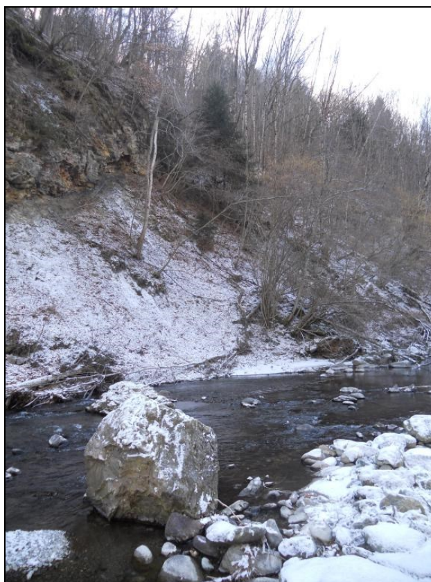
Vista frana in sponda destra
