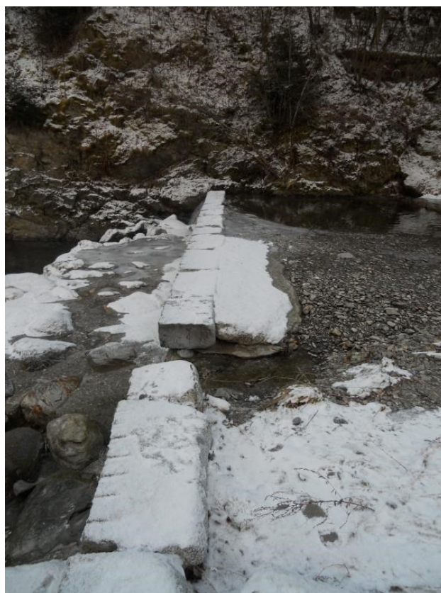
Copertina in pietrame mancante della soglia trasversale
