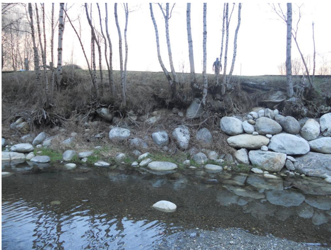
Scarpata erosa in sponda sinistra
