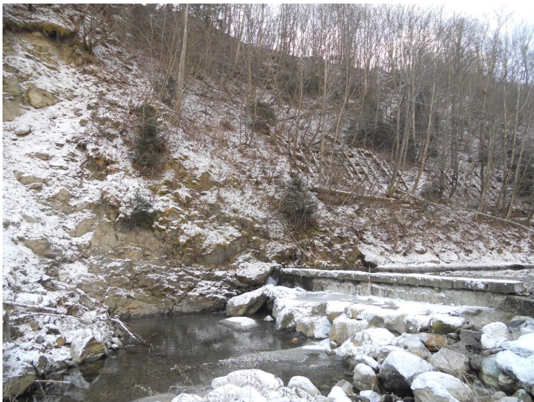
Vista frana in sponda destra
