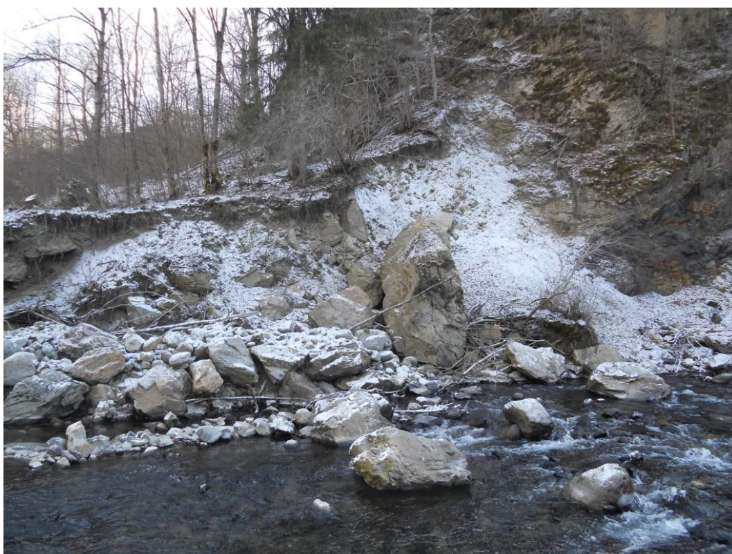
Scarpata erosa e scavernata in sponda destra – presenza masso ciclopico
