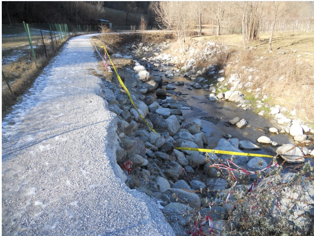
Percorso Vita trascinato in alveo in seguito al crollo della scogliera in sponda destra
