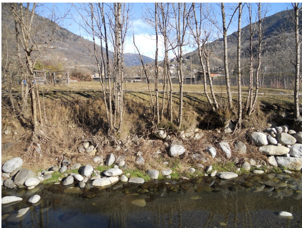
Scarpata erosa in sponda sinistra (vista da sponda destra)
