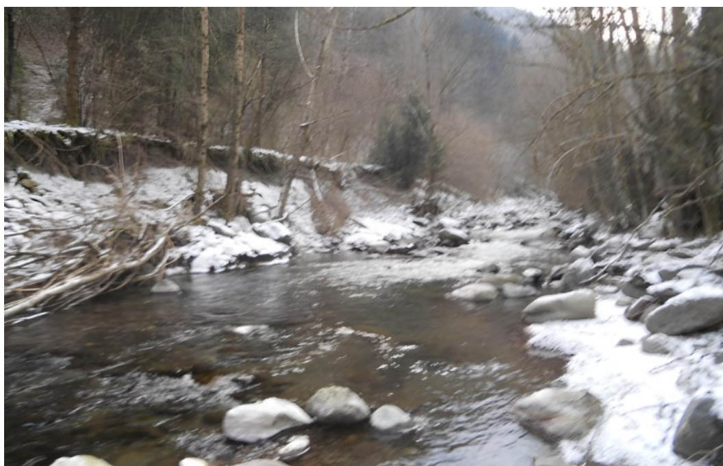
Scarpata erosa e scavernata in sponda destra
