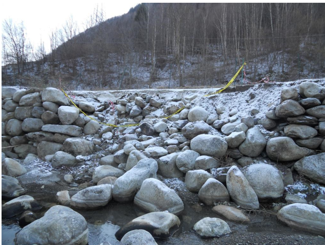
Scogliera crollata in sponda destra
