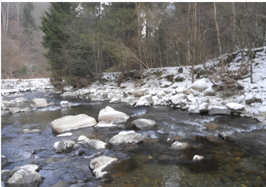
Scarpata erosa e scavernata in sponda destra
