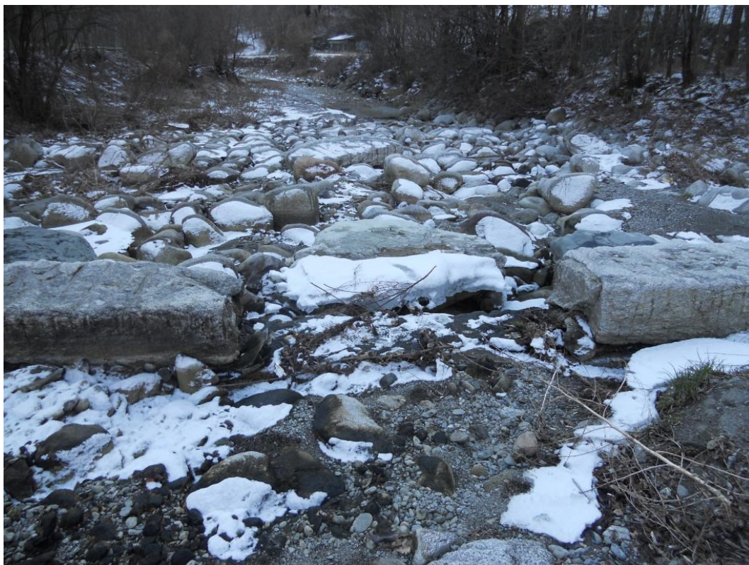
Copertina in pietrame mancante in corrispondenza gaveta soglia trasversale
