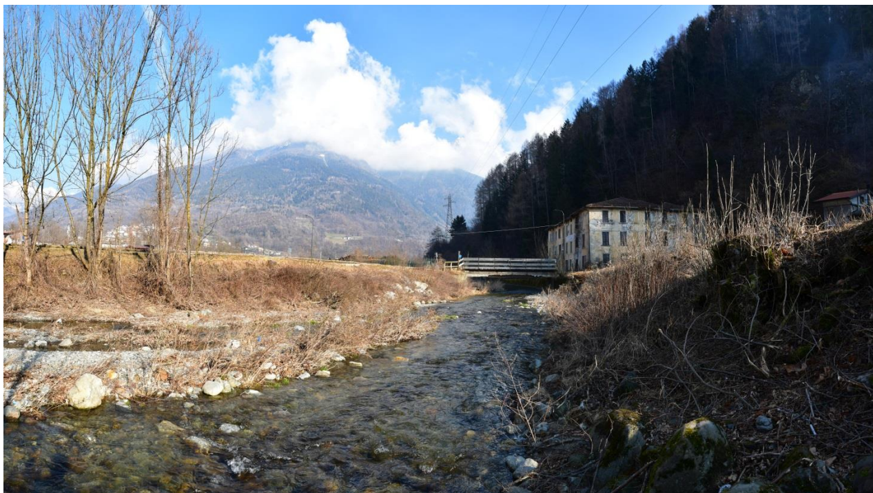
Figura 19: Settore a monte del ponte lesionato di via Sora (loc. "Lazzaretto")
