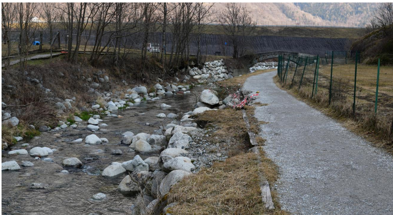
Figura 26: Scogliera crollata in sponda dx e "scavernata" in sponda sx
