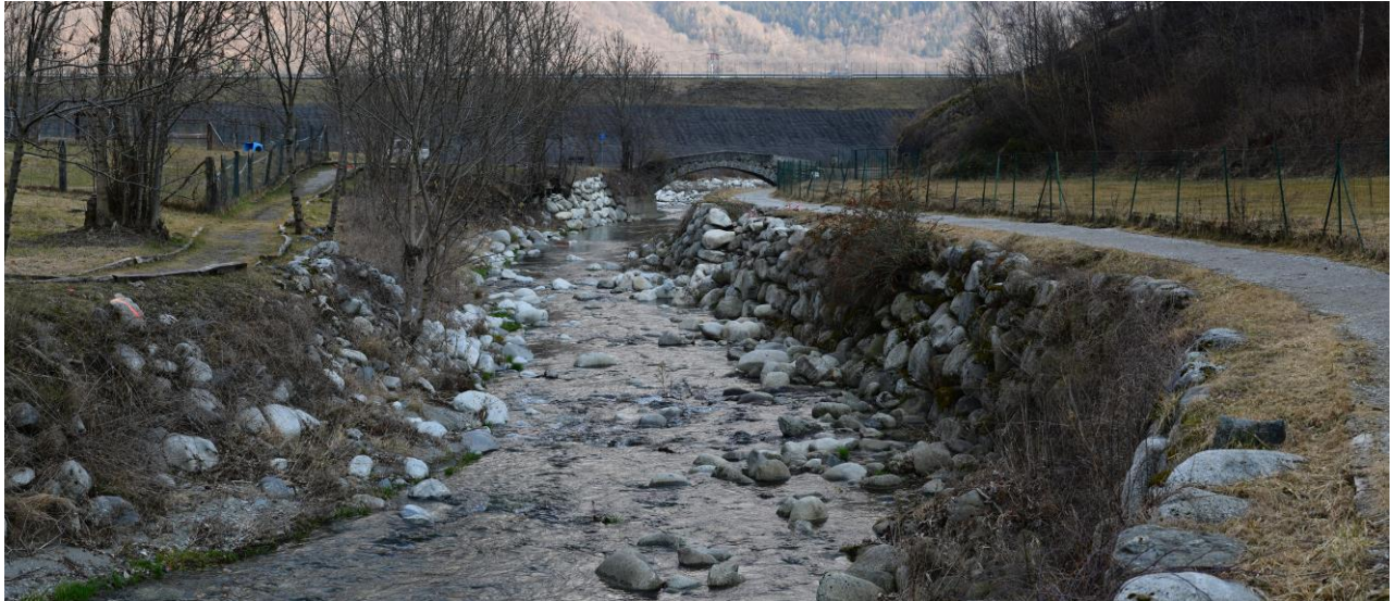
Figura 23: particolare delle difese spondali del tratto terminale del torrente Ogliolo
