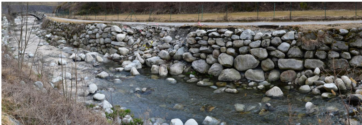
Figura 25: Tratto di scogliera a secco scarsamente intasata e parzialmente crollata
