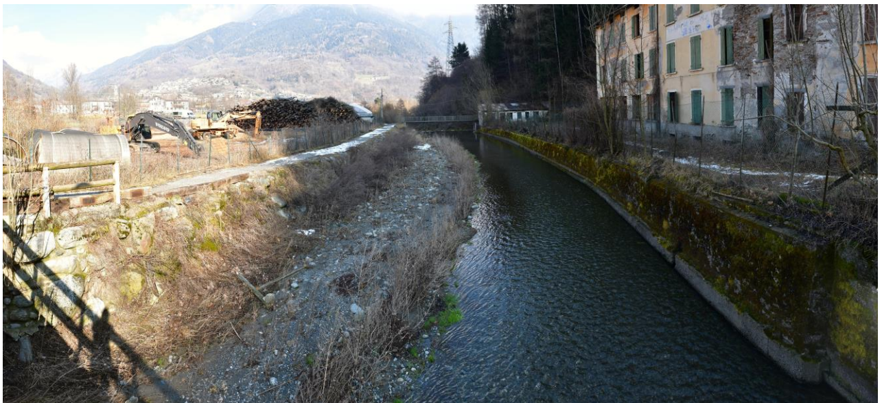
Figura 27: Settore a valle del ponte lesionato con la soglia che condiziona la livelletta di fondo del torrente Ogliolo
