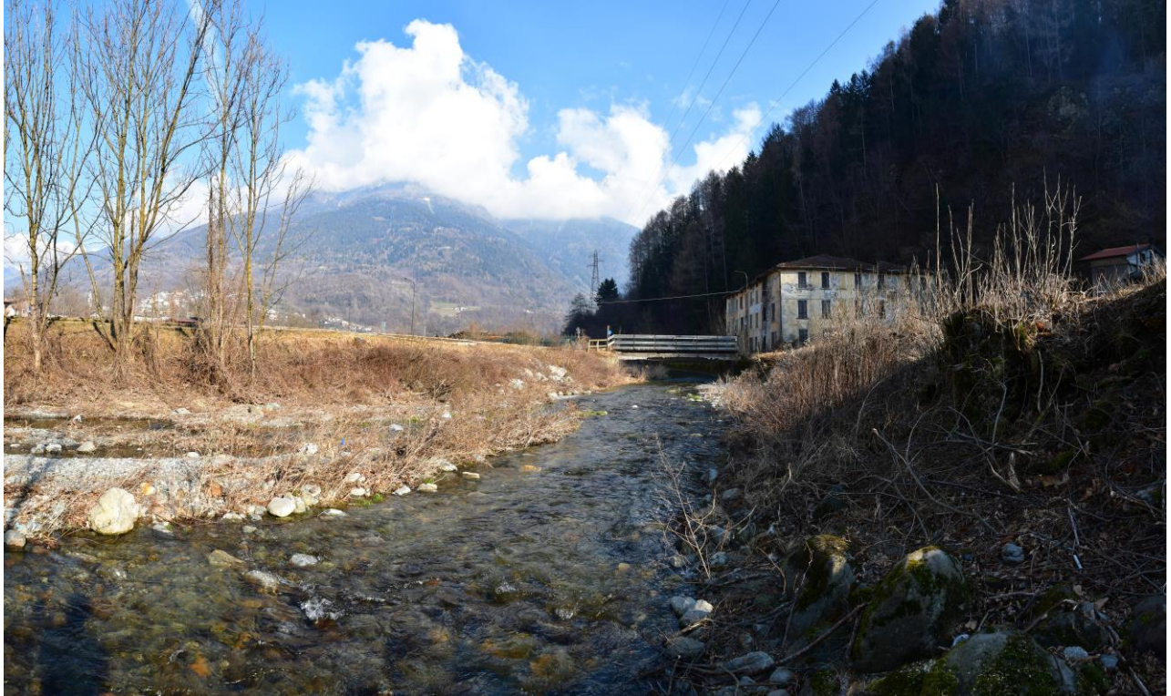
Figura 26: Settore a monte del ponte lesionato di via Sora (loc. "Lazzaretto")
