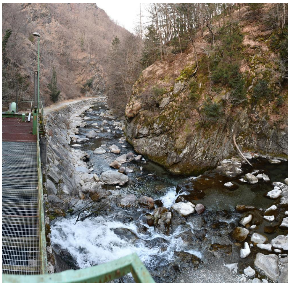
Figura 7: Soglia lesionata posta a ridosso dell'opera di presa
