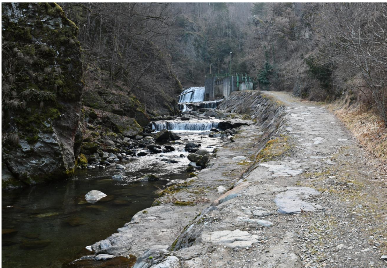
Figura 8: Selciatone lesionato al piede della scogliera in sponda sinistra
