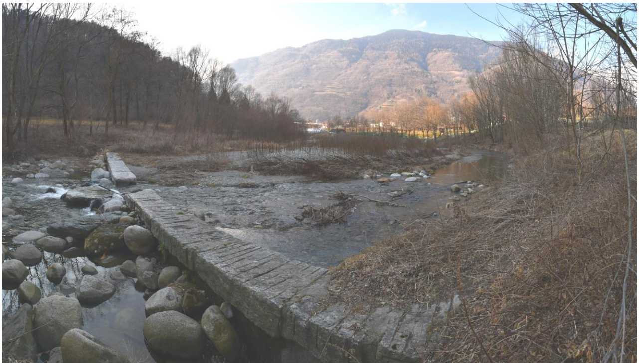
Figura 29: Soglia di fondo nei pressi del termine del termine ampliato da passate attività antropiche
