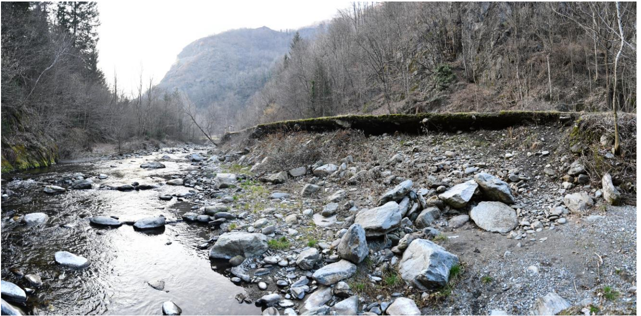
Figura 12: Il fenomeno erosivo visto dal torrente
