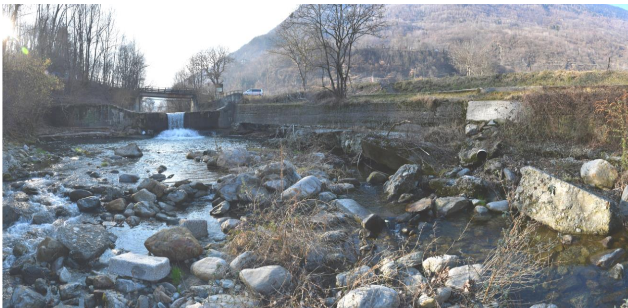
Figura 19: Muro arginale sx scalzato e lesionato
