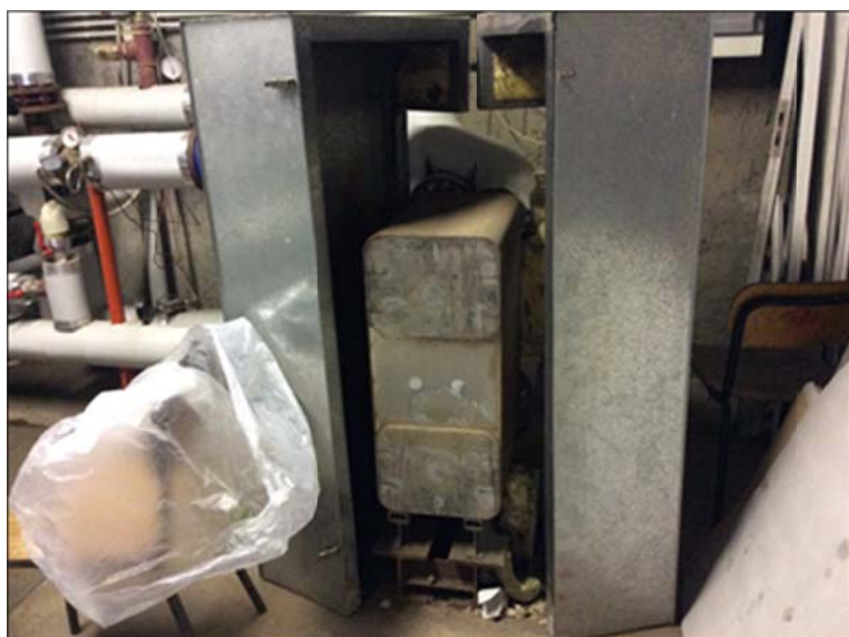
Scambiatore di calore
