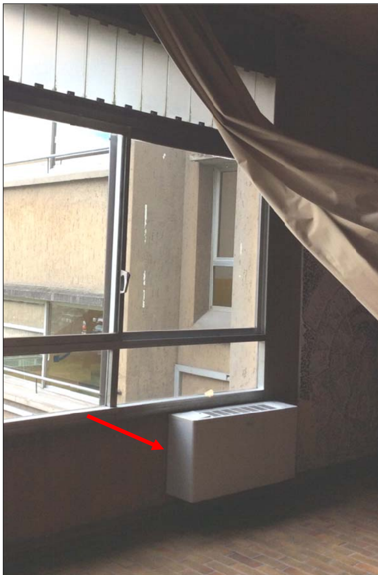
Esempio di ventilconvettori installati
