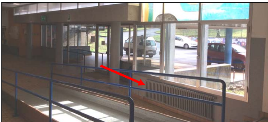
Esempio di radiatori installati
